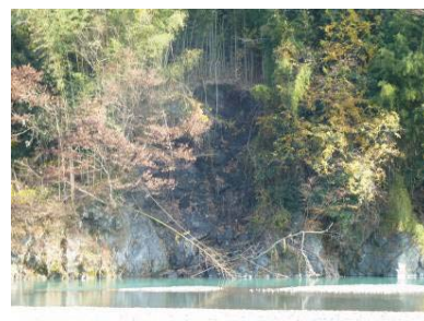
崖線部の崩落箇所は、保護工などの対応についても十分な景観配慮が求められる。
