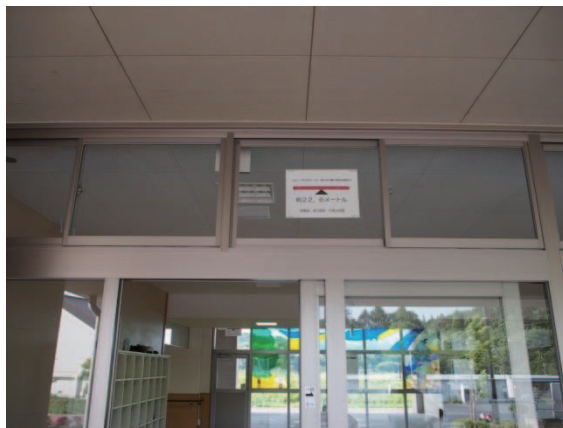
公民館正面玄関の津波の高さを示す表示
