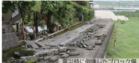
震災時に倒壊したブロック塀
